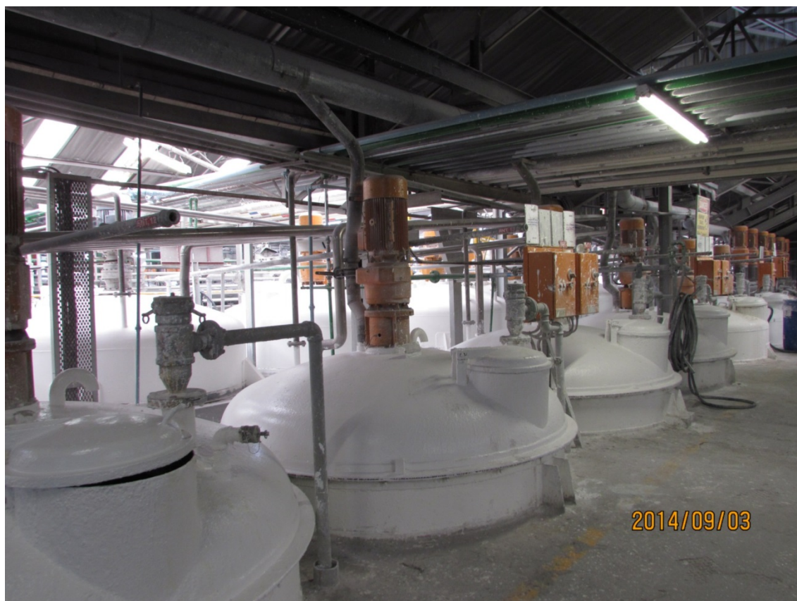
写真2：水性ペイントプラント内部
